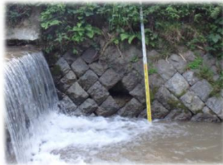
河川護岸の損傷など
